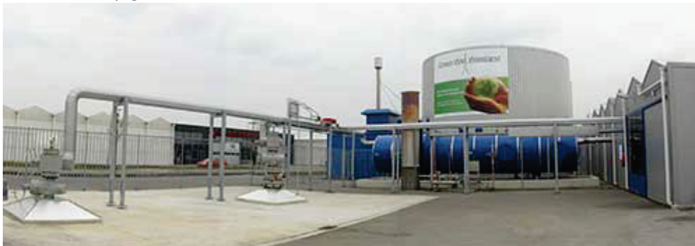
Green Well Westland, acht tuinbouwondernemingen maken gebruik van duurzame aardwarmte. Bron: www.energiek2020.nu
