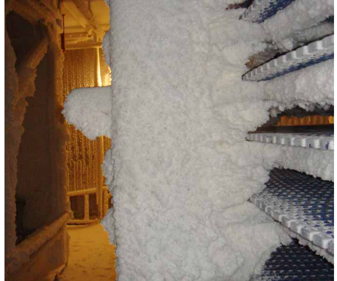
La acumulación de hielo reduce la velocidad del flujo de aire y la eficiencia del sistema.
